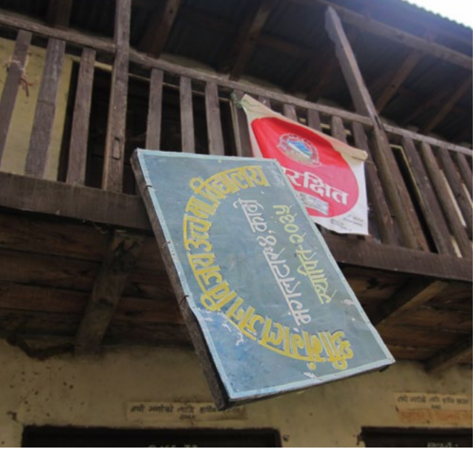
地震によって学校の看板が外れてしまっている
