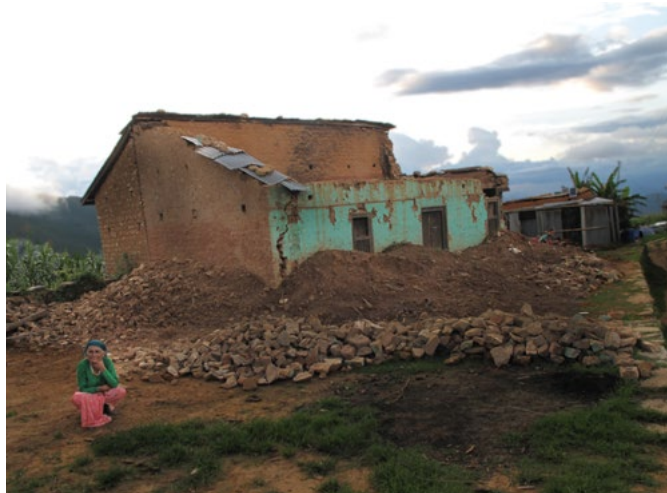
地震で倒壊した家屋
