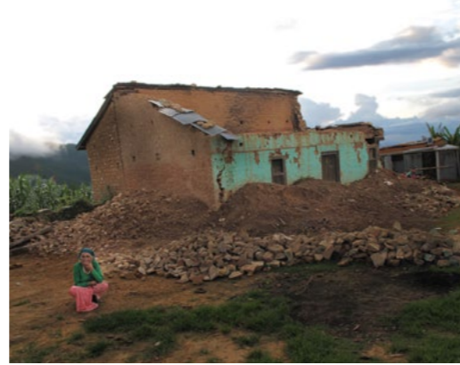
2016 年研修生スリザナさんの出身地ラジャバス村の倒壊した家屋。同村はとりわけ地震の被害が大きかった。
